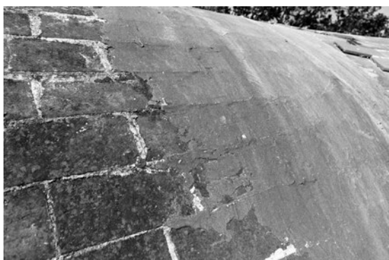
Fig. 26 | Bloque 3, extradós, obras de restauración anteriores de los años 2005-2008 que quedaron inconclusas (créditos: Sara Garuglieri). | Blocco 3, estradosso, interventi di restauro pregressi databili tra gli anni 2005-2008 e rimasti inconclusi (credits: Sara Garuglieri).
