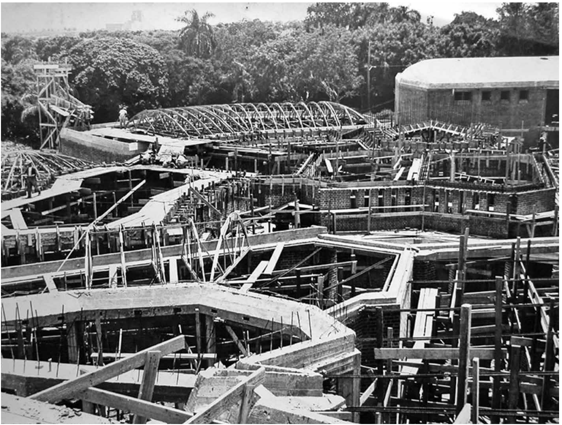
Fig. 17 | Fotografía de la Escuela de Teatro en construcción. Destacan los zunchos de hormigón armado que actúan como punto de apoyo de las cubiertas abovedadas; al fondo, las nervaduras dispuestas para la colocación de las diferentes capas de rasillas (cortesía de Roberto Gottardi). | Fotografia della Scuola di Teatro in costruzione. In evidenza i cordoli in cemento armato che fungono da punto di appoggio per le coperture voltate; sullo sfondo le centine posate in opera per la posa dei diversi strati di tavelle (cortesía di Roberto Gottardi).
