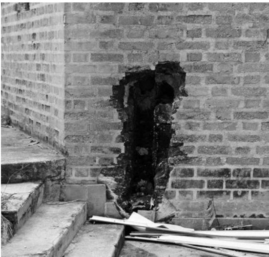
Fig. 8 | Elección tecnológica que implicó un deterioro de los materiales constructivos (créditos: Stefania Aimar). | Scelta tecnologica che ha implicato un deterioramento dei materiali da costruzione (credits: Stefania Aimar).
